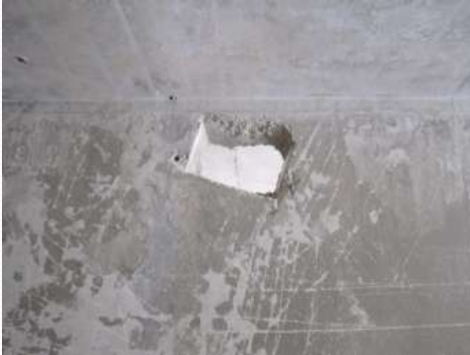
قالب بندی نامناسب کانال کولر (بلوک 4B80 اجرا شده قبل از اعطای مسئولیت به شرکت تدبیر ساحل)
