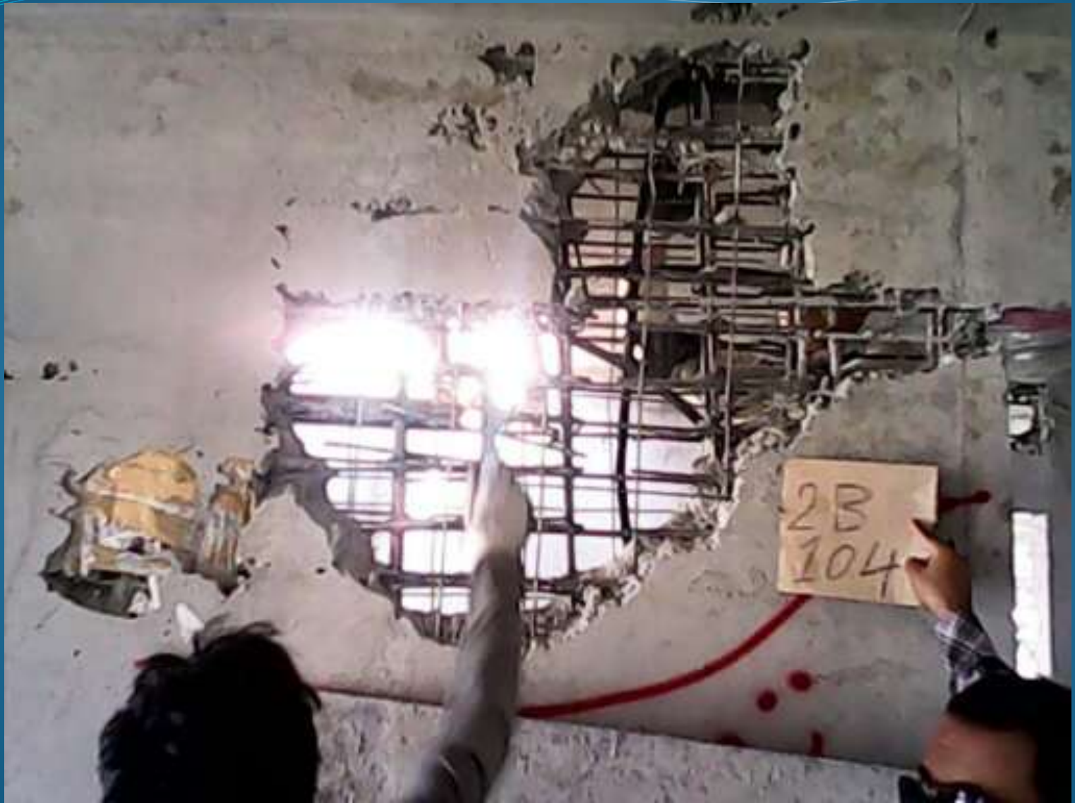
کرمو شدگی متعدد بتن در طبقه اول 2B104
